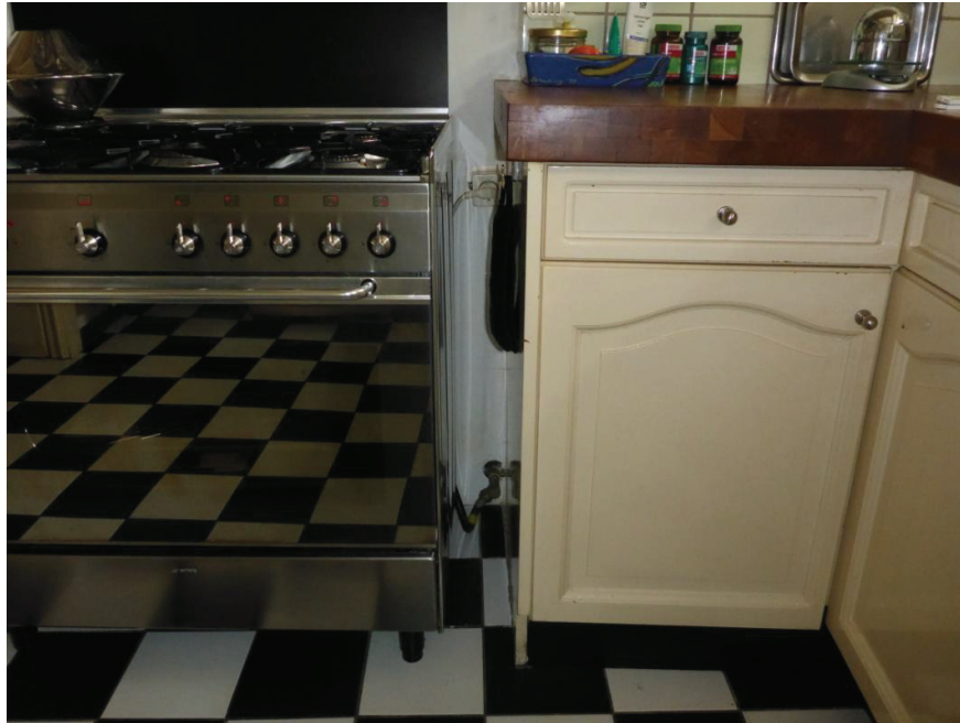
Detailfoto 9: laagst gelegen wand-contactdoos in de keuken
